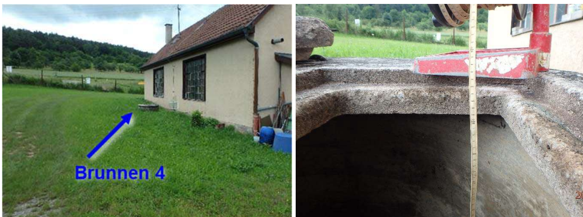
Abbildung 9: Privater Grundwasserbrunnen 4 (Lage siehe Anlage 1)
